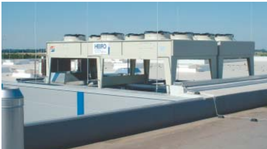
Das Osnabrücker Unternehmen Heifo bietet neben der Kältetechnik auch die erforderliche Überwachung
