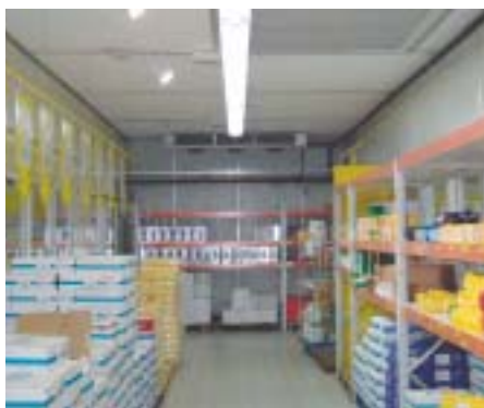
Die Gründe für Störungen in Kühlräumen sind oft banal – die Folgen hingegen gravierend
